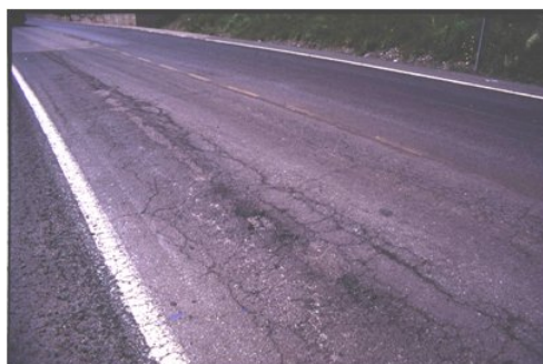
Figura 2.7.- Fallo por fisuración por fatiga
