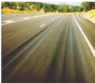
Figura 2.6.- Fallo por deformaciones plásticas
