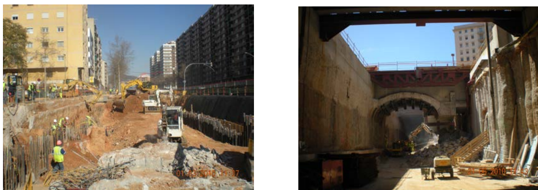
Figura 5.1.- Obras para la estación de cercanías de las líneas C3 y C4. (Barcelona)
