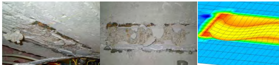
(b) Detalle de la zona despegada
