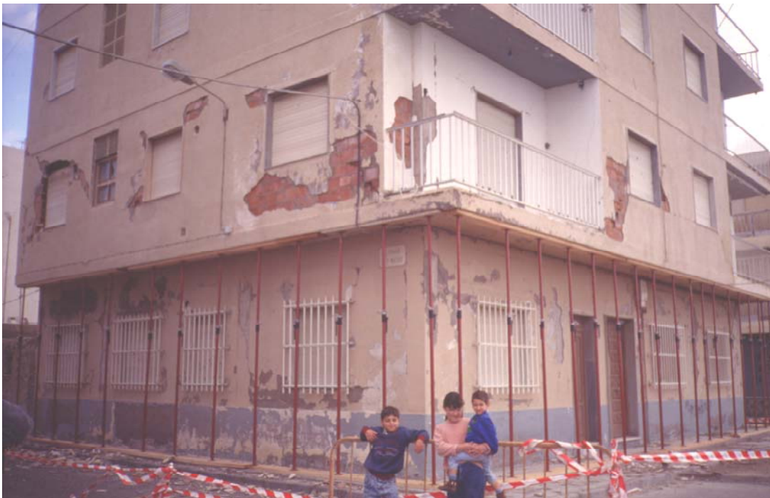
Foto 7.1 Daños en edificio de viviendas en el pueblo de Balerna.
