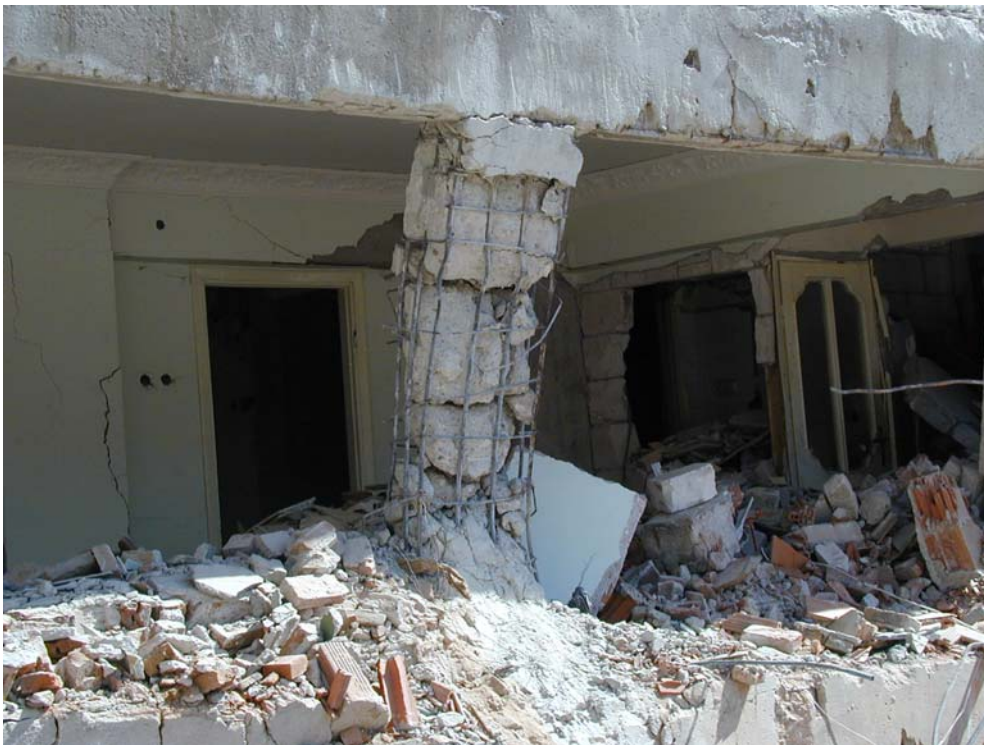
Foto 7.14 Fallo de pilar, efecto viga fuerte - pilar débil.
