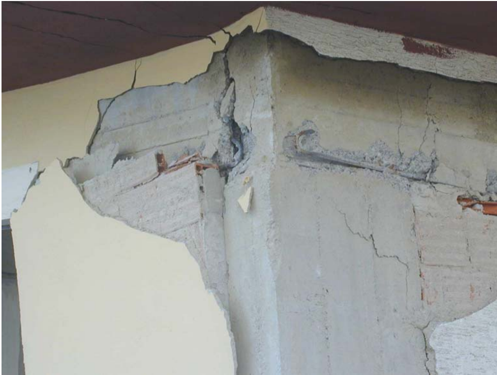
Foto 7.10 Falla de una junta de elemento de hormigón reforzado.
