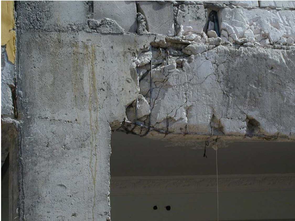
Foto 7.12 Formación de rótula plástica en viga.
