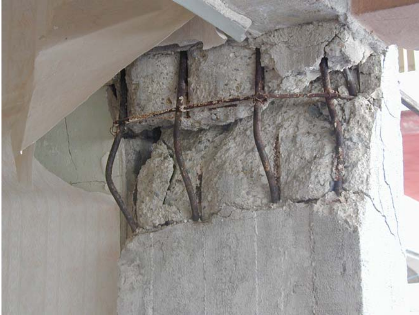
Foto 7.15 Fallo local de pilar por inadecuado refuerzo de confinamiento.
